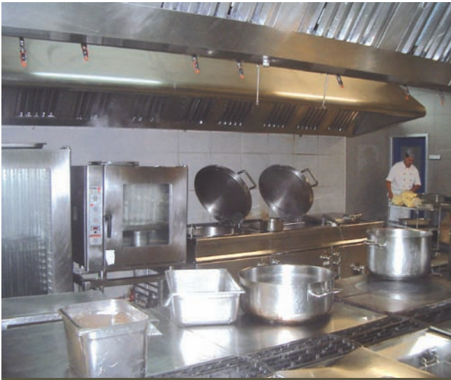
3.11. Instalaciones de cocina hospitalaria.
